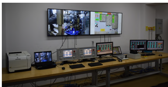
Camera de Comandă și Control,
