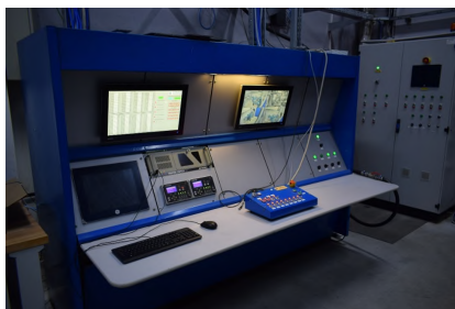
Consolă comandă și control instalatii auxiliare stand
